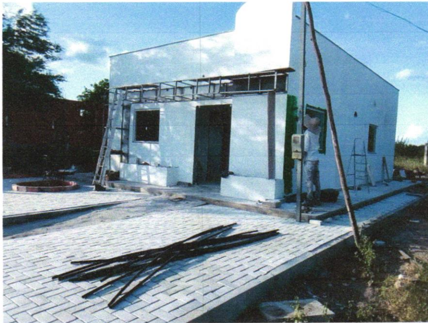
FOTO 01 – APLICAÇÃO MANUAL DE PINTURA COM TINTA LÁTEX ACRÍLICA EM PAREDES, DUAS DEMÃOS. AF_06/2014
